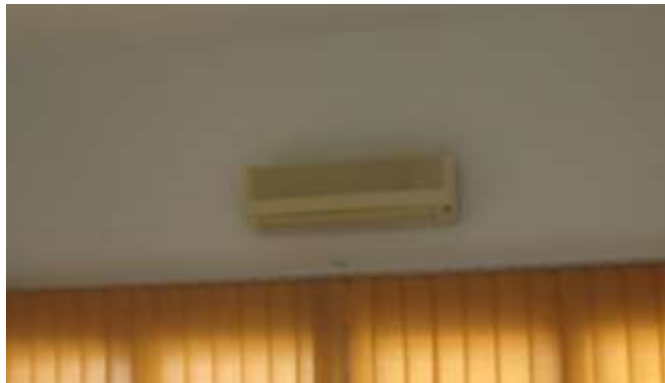
Equipos de aire acondicionado/calor en edificio de oficinas y cabina de báscula.
